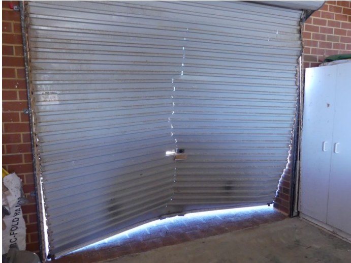
Roller door failure
